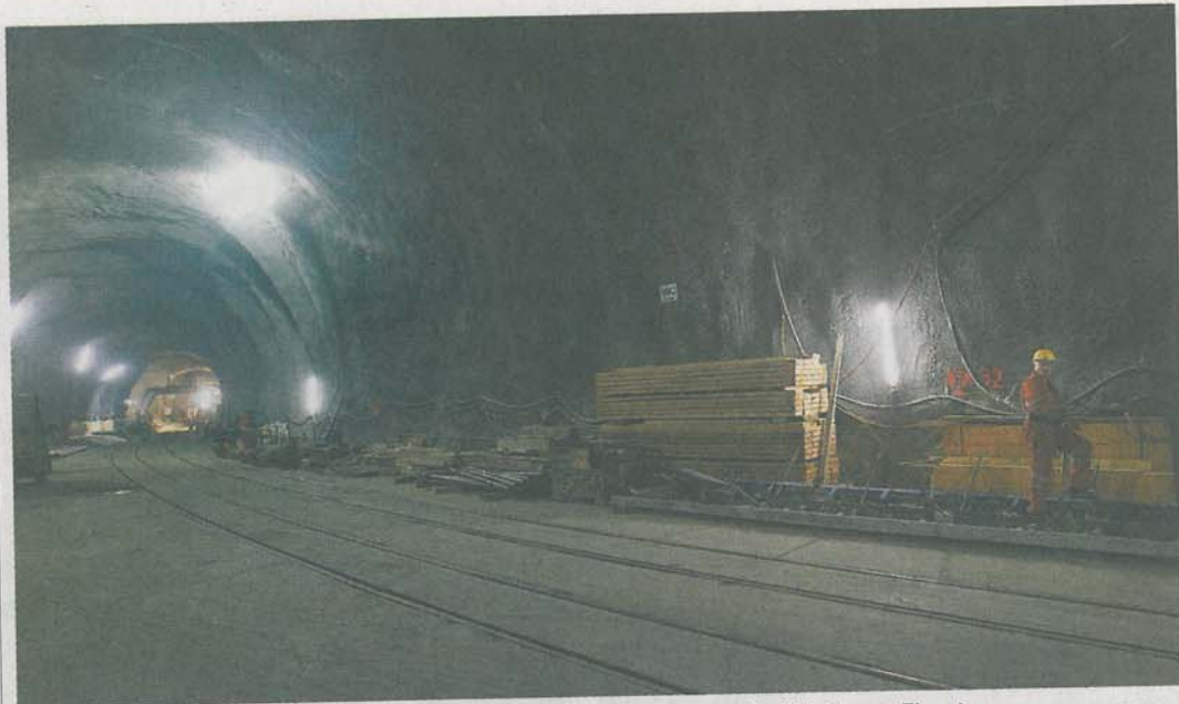
Im Gotthardtunnel kommt ab September eine Betoniermaschine aus Kirchbichl zum Einsatz. Foto: Reuters/Wiegmann
